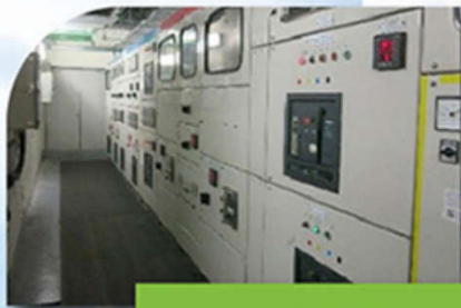
電力裝置 Electrical installation
