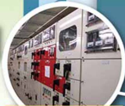
電力裝置 Electrical installation
