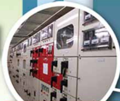
電力裝置 Electrical installation
