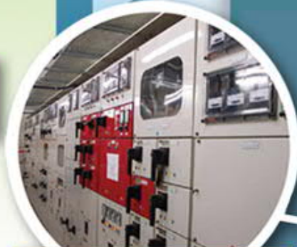
電力裝置 Electrical installation
