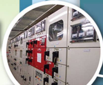
電力裝置 Electrical installation
