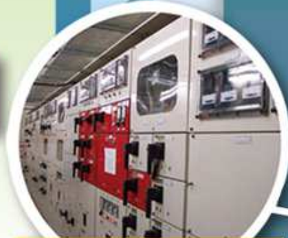
電力裝置 Electrical installation
