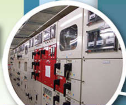
電力裝置 Electrical installation
