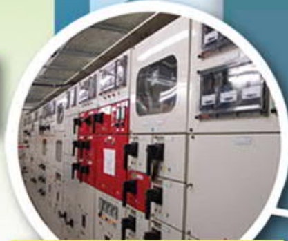
電力裝置 Electrical installation
